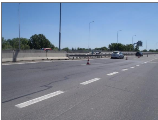
Deformace vozovky dálnice D47 v roce 2013 (po prvních opravách)
