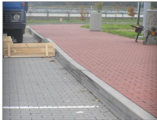
Deformace chodníku na čerpací stanici u D47 před opravou v r. 2016
