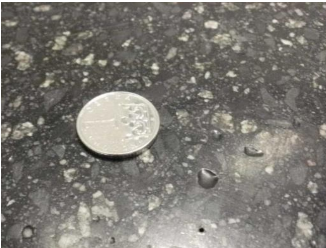
Bublinky na podlaze z litého asfaltu
