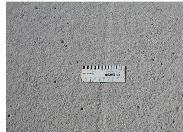
Vzduchové kanálky v mostovce. Zdroj: Vlastní..
