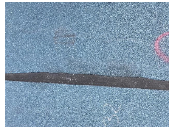
Velký výtok asfaltové hmoty. Zdroj: Vlastní..
